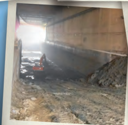
la mise en œuvre de la cale de mise à l'eau dans le K1
